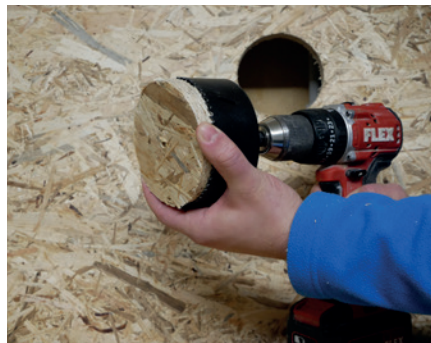
1.2 Bohrkern entnehmen Bohrkern entnehmen und entsorgen. Die Öffnung ist nun für die Einblasdämmung vorbereitet.
