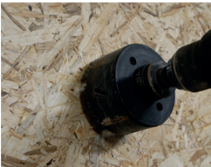
1.1 Einblasöffnung herstellen Position der Einblasöffnung festlegen und markieren. Öffnung mit geeignetem Lochsäge- und Bohrdurchmesser sauber herstellen.
