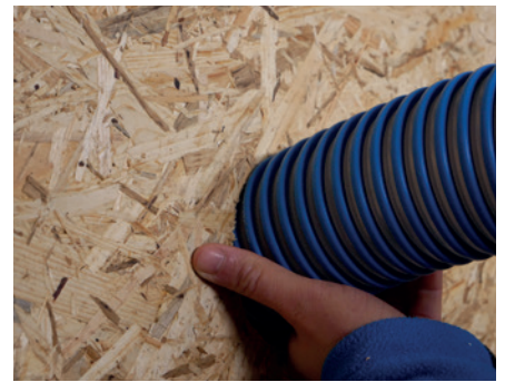
1.3 Einblasdämmung einbringen Einblasschlauch mit Abdichtschwamm einsetzen. Dämmstoff gemäß Verdichtungstabelle einbringen und das Gefach vollständig und gleichmäßig befüllen.
